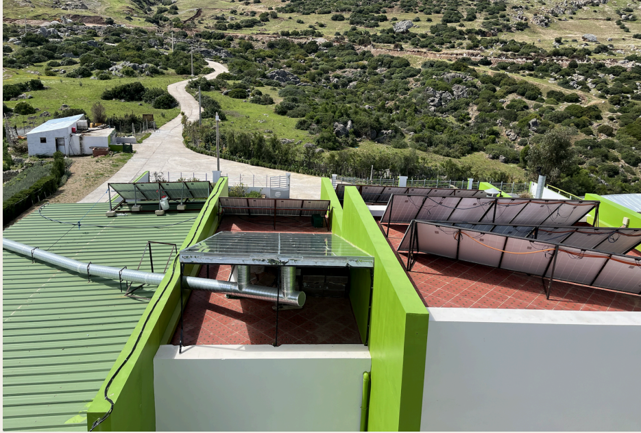
Panel solar y bomba de calor aerotérmica Foto: Xiao Chenjuan (Juliet)
